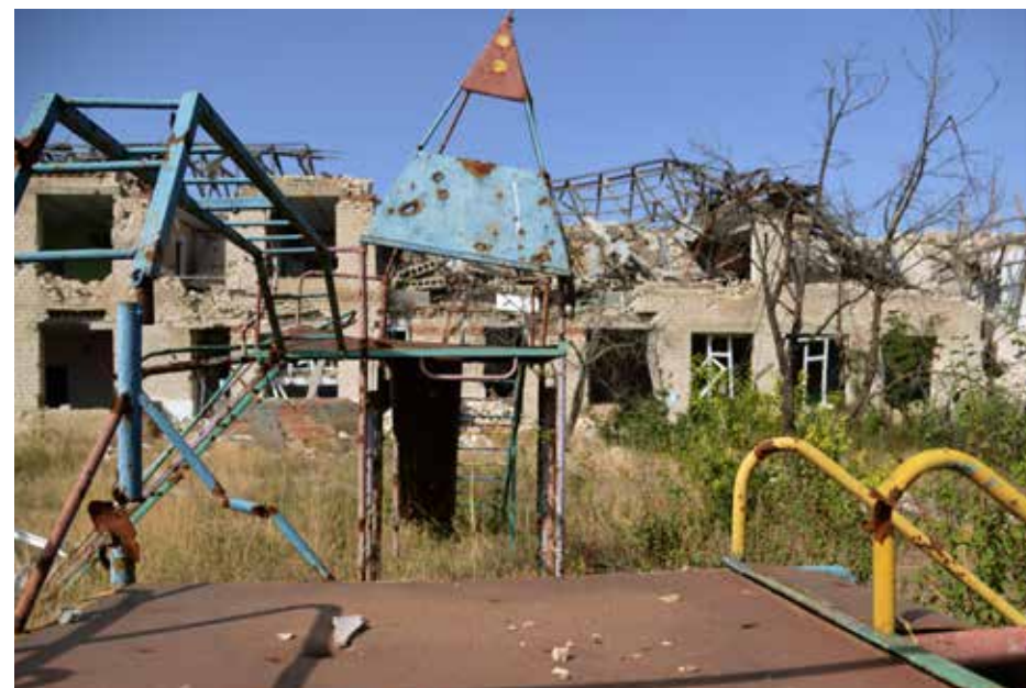
28 Granaten schlugen in das Gebäude ein. In Anbetracht der Anzahl kann davon ausgegangen werden, dass diese Schule gezielt von den Russen angegriffen wurde. Nach einem solchen Beschuss ist die Schule nicht mehr zu reparieren: Zweigstelle Zarytschenka der Grundschul- und Vorschulbildungseinrichtung „Archangelsker Unterstützungseinrichtung für die allgemeine Sekundarbildung“ der Gemeindeverwaltung Wyssokopil, Dorf Zarychne. 📷 Educational Human Rights House Chernihiv
