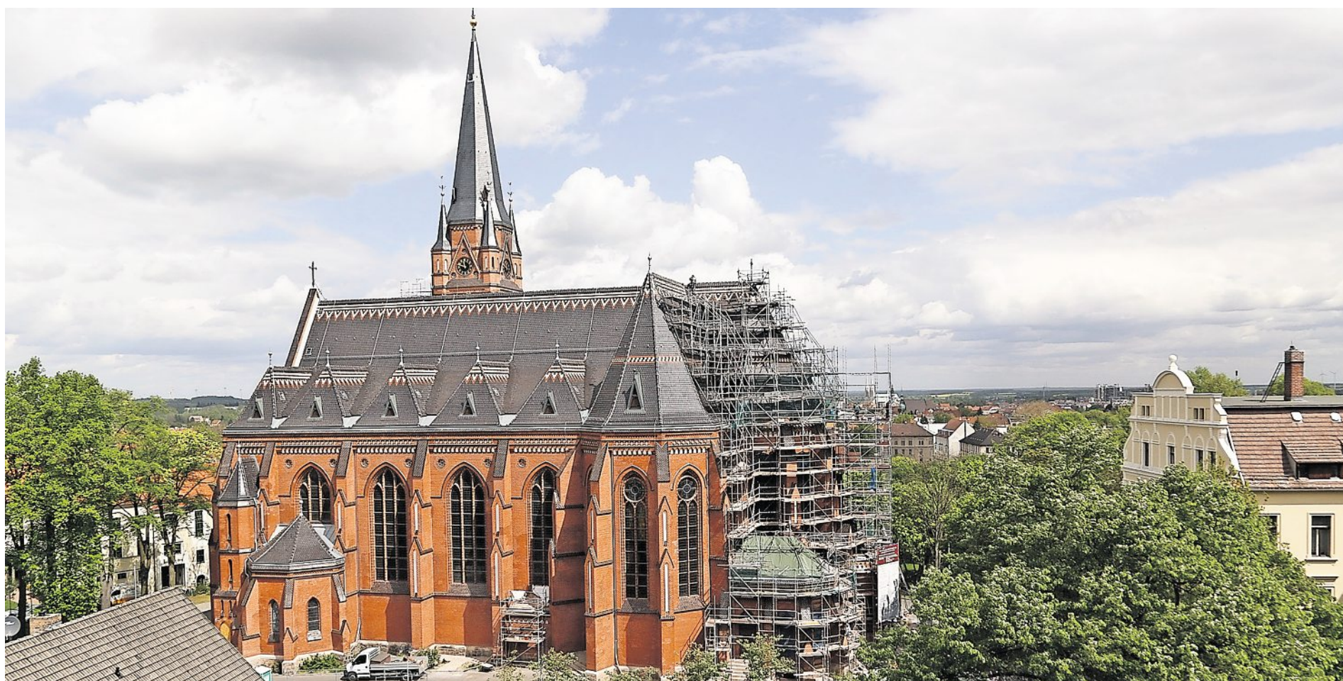
Großer Brocken: Die äußere Sanierung der St.-Jakobus-Kathedrale war ein enormer Kraftakt für das kleinste Bistum Deutschlands.
