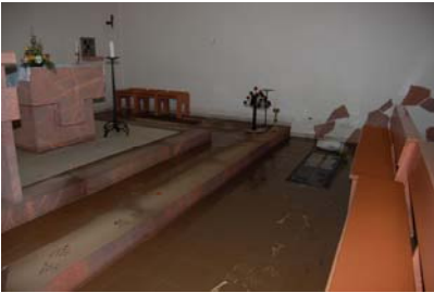
Nachdem das Wasser abgeflossen war, blieben Schlamm und durchnässte Wände zurück. Foto: privat
